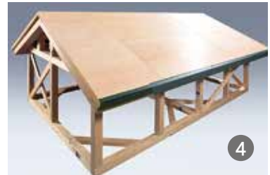
6 통기 지붕널을 시공하고, 처마 끝 부분에 처마 끝 환기구와 처마 물받이(대)를 설치합니다. 지붕마루부는 산자판을 잘라 개구부를 만듭니다.
