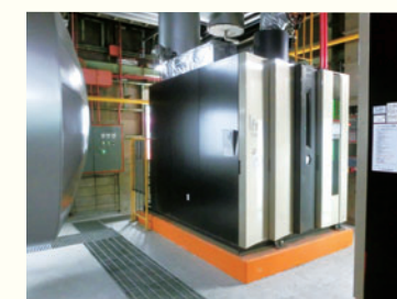
高効率ボイラー
