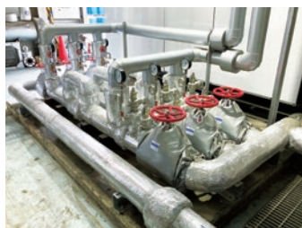
ボイラー熱回収装置 (足利)
