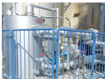
ボイラ熱交換 (伊賀)
