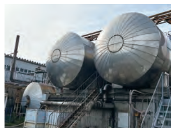
アキュムレーター放熱ロス対策 (北九州工場)
