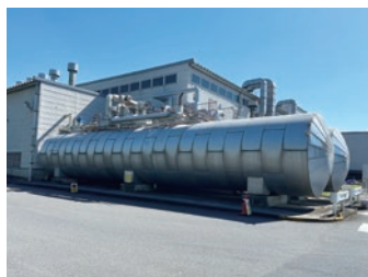
蒸気回収用アキュムレーター(足利工場)
