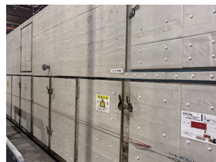
乾燥機の壁面断熱(足利工場)
