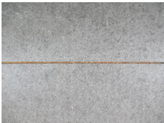
目地部の下処理を行わなかった例 (写真は合板下地)
